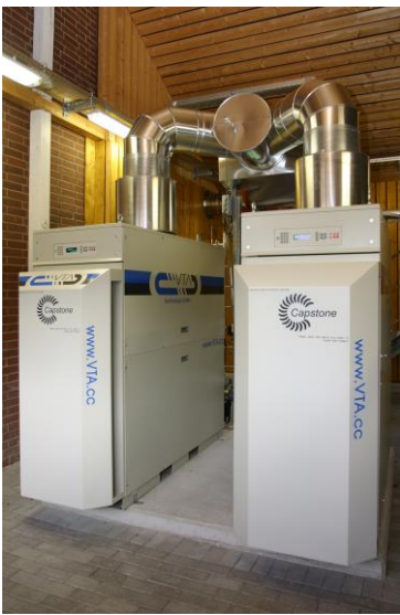
Abb.: Microturbine Kläranlage Warendorf
